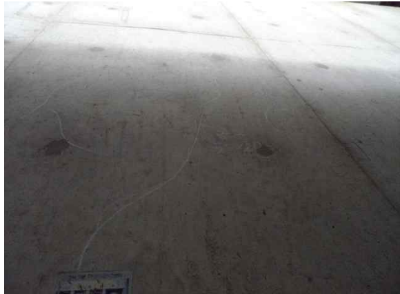
P1 코핑부 균열(폭 0.2mm)
