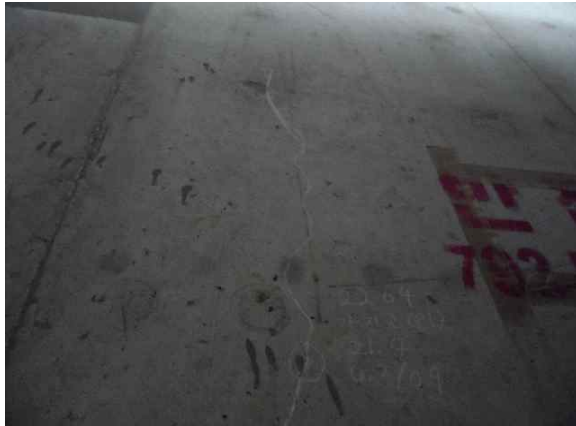
P1 코핑부 균열(폭 0.2mm)
